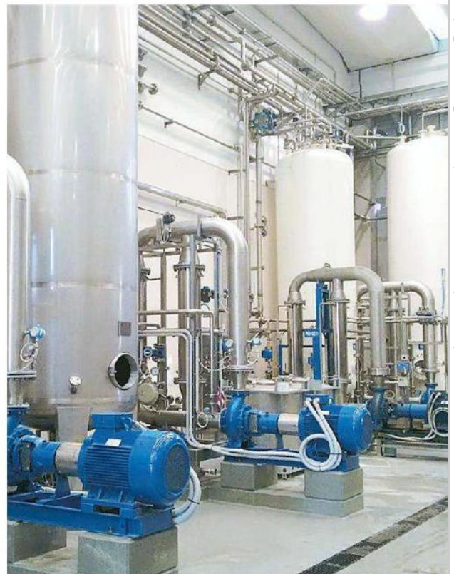
Nella foto un dettaglio degli impianti di microfiltrazione di Sicit
